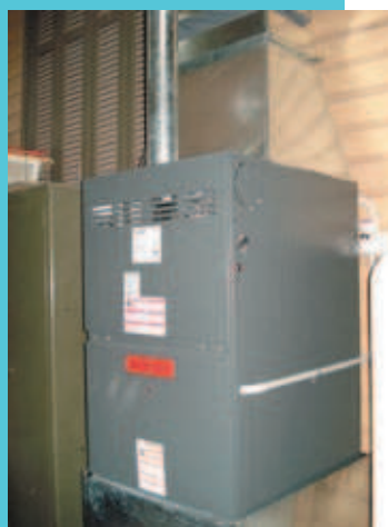
Equipo de calefacción a gas
