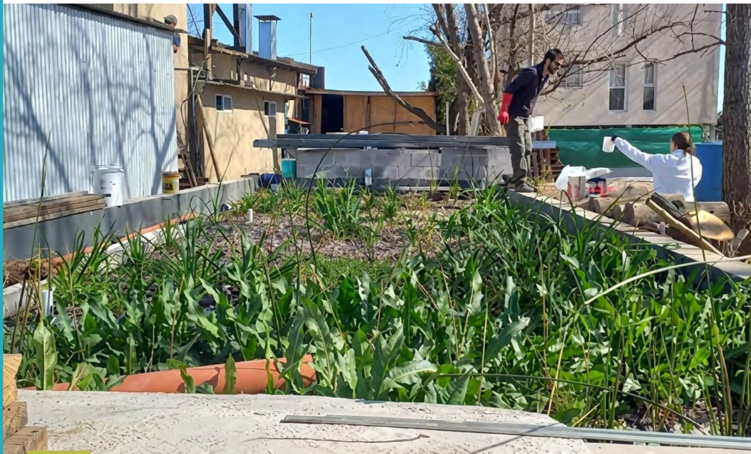
Figura 5. Imagen del humedal de flujo horizontal visto desde el extremo final hacia la cámara séptica. Foto: Tania Dellepiane.
